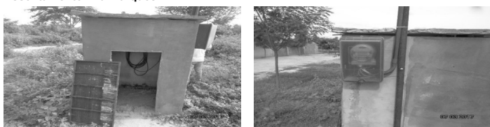
Figura 61 – Abrigo do quadro de comando da bomba e caixa de luz – SAA Isolado Assentamento Vila Marques
