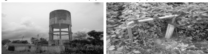
Figura 41 – Reservatório de concreto (capacidade de 140m³) e poço 5 – SAA Sede
