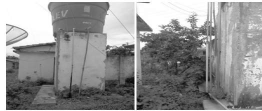
Figura 48 – Reservatório (capacidade de 5m³) e tubulações improvisadas na entrada e saída do reservatório – SAA Isolado Bairro BR – II
