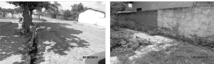
Figura 70 – Esgoto escoando pela sarjeta (à esquerda) e solução individual de esgotamento construída sob o passeio público (à direita) – ambos no centro de Nazaré do Piauí
