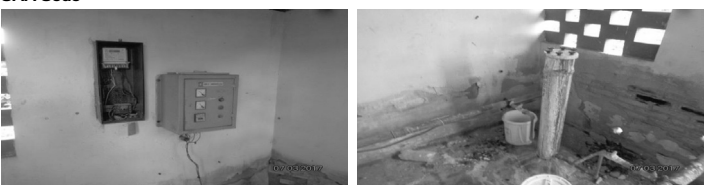
Figura 38 – Quadro de comando da bomba e sistema de simples desinfecção do Poço 3 – SAA Sede
