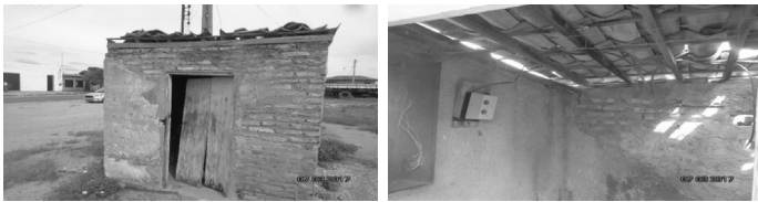
Figura 45 – Abrigo e quadro de comando – SAA Isolado Bairro BR - I
